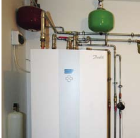
10 Pompa ciepła firmy Danfoss DHP-C 8 o mocy 8 kW. Jednostka ta jest wyposażona w zbiornik ciepłej wody użytkowej o pojemności 180 litrów (z bardzo wydajną wężownicą) oraz moduł chłodzenia pasywnego. Latem ciepło odbierane z posadzki jest przekazywane do dolnego źródła i niejako „ładuje” je na kolejny sezon. Podłużny element z tworzywa po lewej stronie to zbiornik wyrównawczy dolnego źródła, który zapewnia stałe ciśnienie roztworu glikolowego w układzie. Czerwony zbiornik nad pompą, to naczynie przeponowe centralnego ogrzewania, zielone – ciepłej wody użytkowej. Rury ogrzewania należą do systemu SANHATherm, który jest systemem zaciskowym
